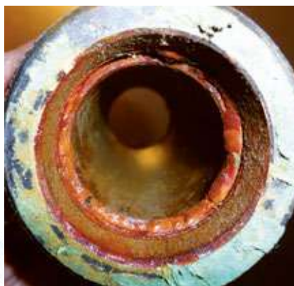
36 mois après l'installation de Aqua-4D®
