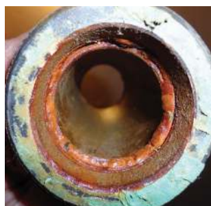
Inspection de la même tuyauterie 36 mois après l'installation du système Aqua4D®.
