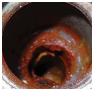
Photo de l'intérieur de la tuyauterie d'eau froide après 14 mois de traitement avec le système Aqua4D®.
