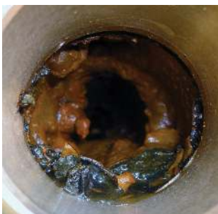
Photo de l'intérieur de la tuyauterie d'eau froide. Photo prise avant l'installation du système Aqua4D®.
