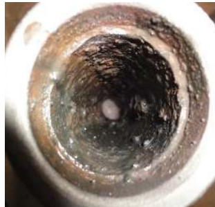
Etat de la tuyauterie après 24 mois de traitement Aqua4D®.
