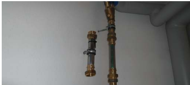
Installation d'un tube de contrôle dans une villa pour vérifier l'état des installations dans le temps.
